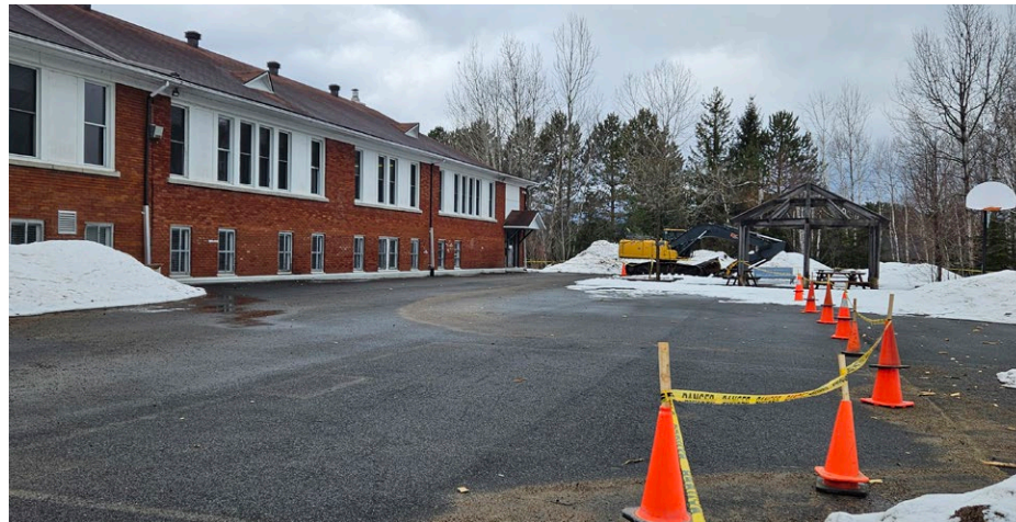
À l'arrière de l'école Sacré-Coeur à St-Donat, une partie de la cour a été tronquée afin qu'une zone de travail sécurisée y soit aménagée. Jusqu'à la fin de l'année scolaire, la patience sera de mise pour les gens fréquentant l'école. (Photo Journal Altitude - Julie Leclerc)
