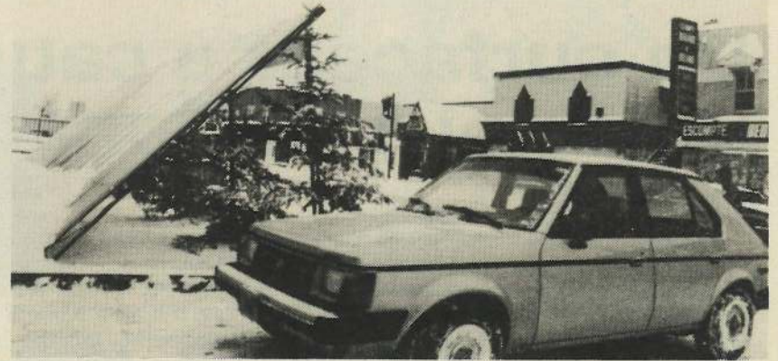
L'hiver a commencé très tôt cette saison. Aux premières chutes de neige, la marquise de Boutique de vêtements St-Donat, rue Principale, n'a pu supporter le poids. Heureusement que les dommages furent minimes.
